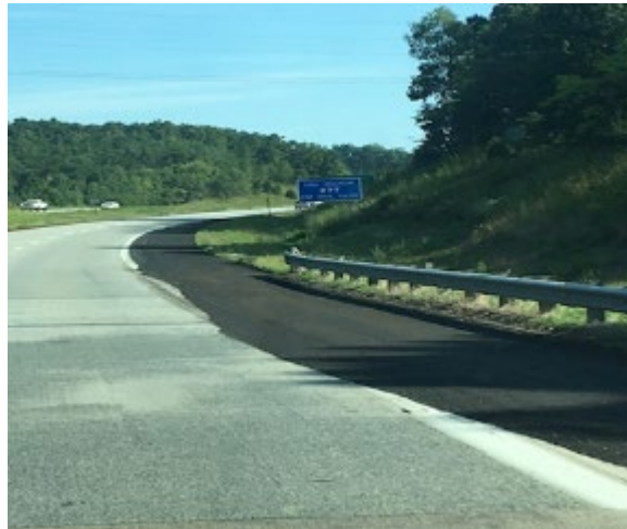
Figure 67 - Unacceptable Edge Line
